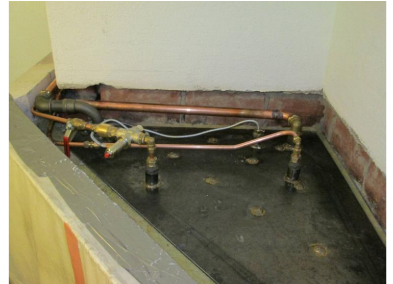
Jälkiasennettu lämmönvaihdin Voi olla myös kattilatyypinen! Kuvassa: Tupauunit vaihdin
